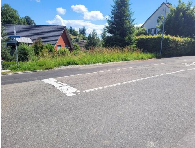
Abbildung 14: Diverse Belagsflicke, Verformungen
